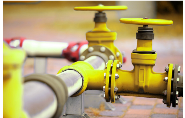
Gasnetze sind eine kritische Versorgungsinfrastruktur und bedürfen der kontinuierlichen Überwachung.
